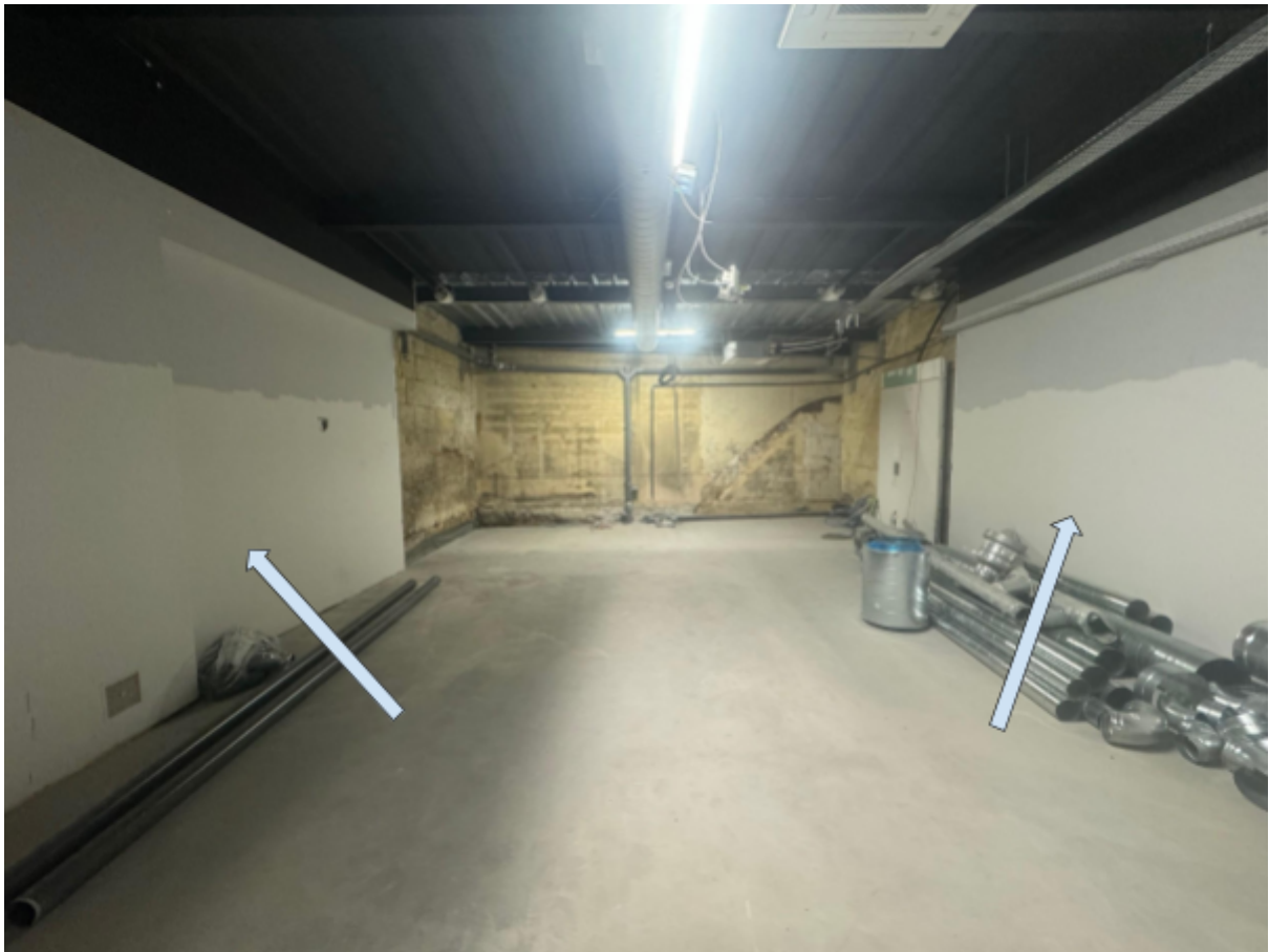
Photo de deux murs initialement proposé de démolir, mais Isospace a voulu conserver. L'adaptation de ces murs au fichier de conception n'est pas possible
